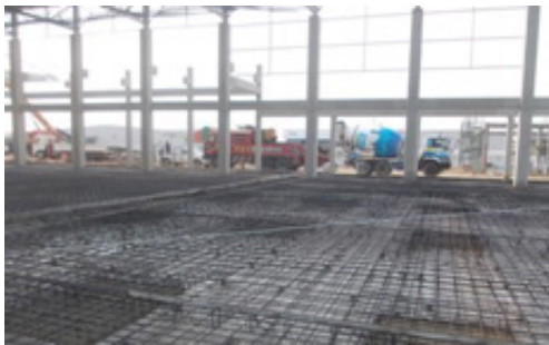
รูปที่ 2 งานวางเหล็กเพื่อเตรียมเทพื้นคอนกรีตในโรงงานอุตสาหกรรม
