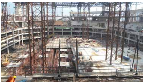
รูปที่ 8 เสา temporary support ที่ออกแบบใหม่สำหรับวิธีใช้เหล็กรับแรงดึง
