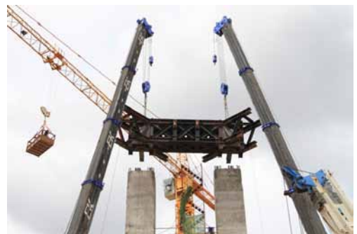
รูปที่ 9 การยกติดตั้ง main truss ที่แบ่งเป็นส่วนสำหรับวิธีใช้เหล็กรับแรงดึง
