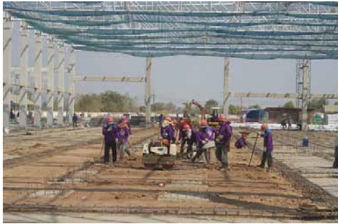
รูปที่ 1 งานเทพื้นคอนกรีตในโรงงานอุตสาหกรรม
