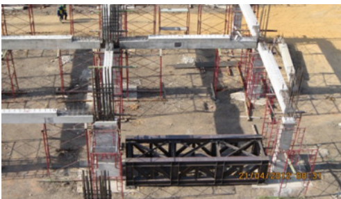
รูปที่ 12 การทำงานด้านล่างตลอดจนการวางชิ้น main truss เพื่อเตรียมยกขึ้นติดตั้งสำหรับวิธีใช้เหล็กรับแรงดึง
